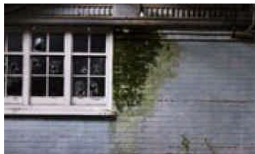
Wilgoć penetrująca jest bardziej zauważalna podczas deszczu
